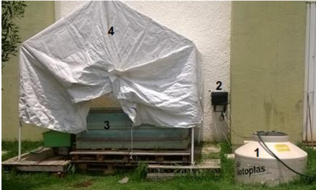
Figura 12. Fotografía de la ubicación de los componentes del sistema de tratamiento. 1) Tanque de almacenamiento, 2) Bomba peristáltica, 3) HA-FHSS, 4) Carpa protectora.
